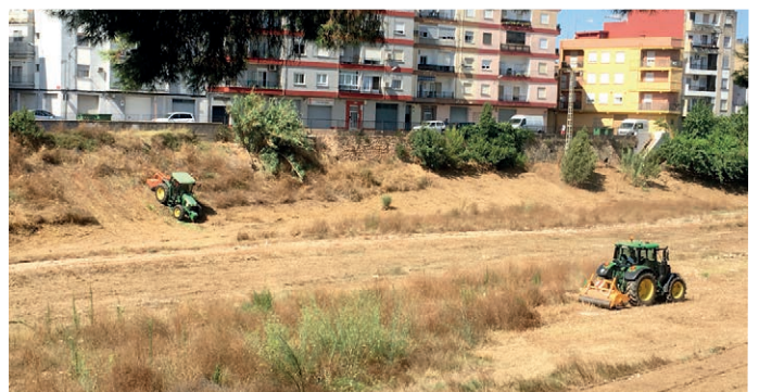
Neteja i desbrossament. El desbrossament del barranc de Xiva ha arribat, com cada estiu, precedit per les tasques de retirada de canyes arrossegades pels temporals.
